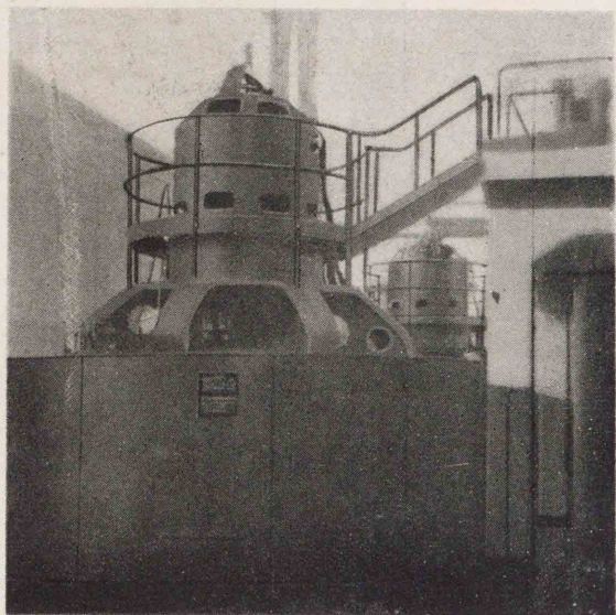
發電室の一部（發電機）
